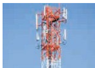
Базовая станция сотовой связи
